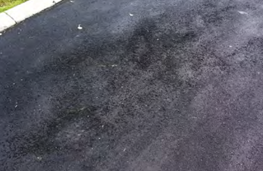
Figur 2. Ved udlægning af tynde lag på uoprettet underlag er stor risiko for dårlig komprimering. Den nye asfalt kan i værste fald smuldre bort.
