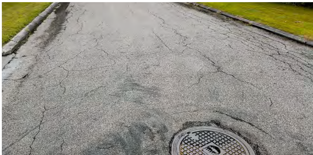
Figur 1. Gamle udtjente belægninger er ofte fulde af revner og sætninger.
