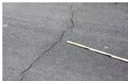
Figur 3. Revnegennemslag i nyt slidlag på grund af ophærdet GAB.
